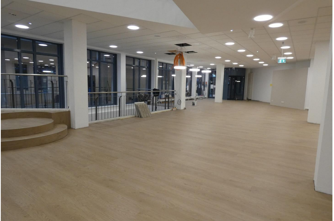
Zwischenbilanz der Neugestaltung im Dezember: auch das Erdgeschoss ist nun mit LED-Leuchten ausgestattet, ein neuer Vinylboden wurde verlegt...
